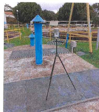
Figura 3. ETAR de Colares – Tanque de Arejamento
